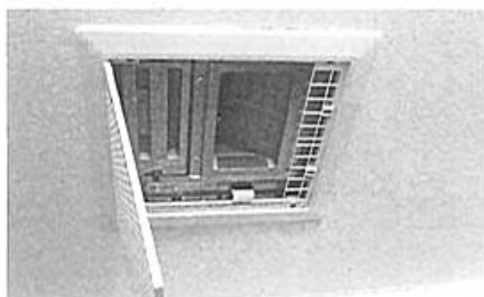
天井に設置された熱交換換気の点検口を開けると掃除ができる
